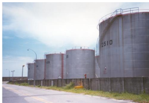
碳鋼儲槽(750KL-3,000KL)
