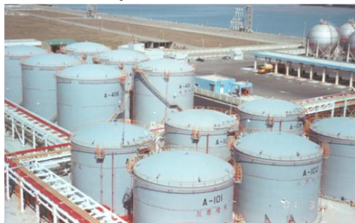
不鏽鋼儲槽(1,500KL & 2,500KL)
