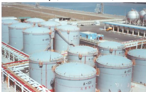
不鏽鋼儲槽(1,500KL & 2,500KL)
